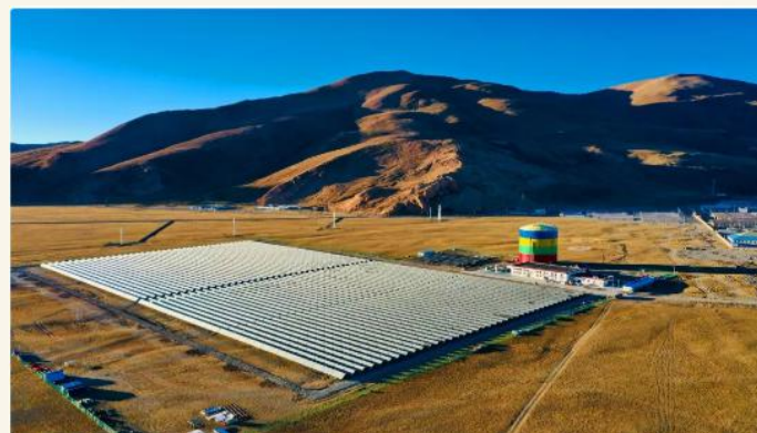
西藏仲巴县太阳能供热工程
