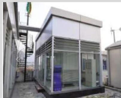
图 1 制冷机组设备间
