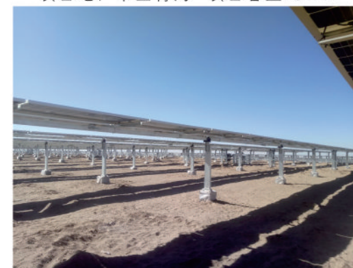
澳大利亚光伏项目
