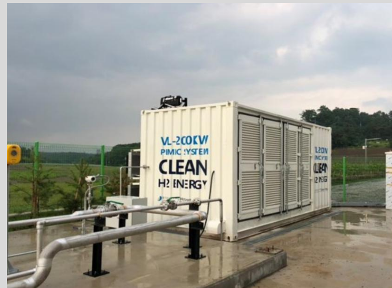
韩国某燃料电池并网项目 （固定式发电系统）
