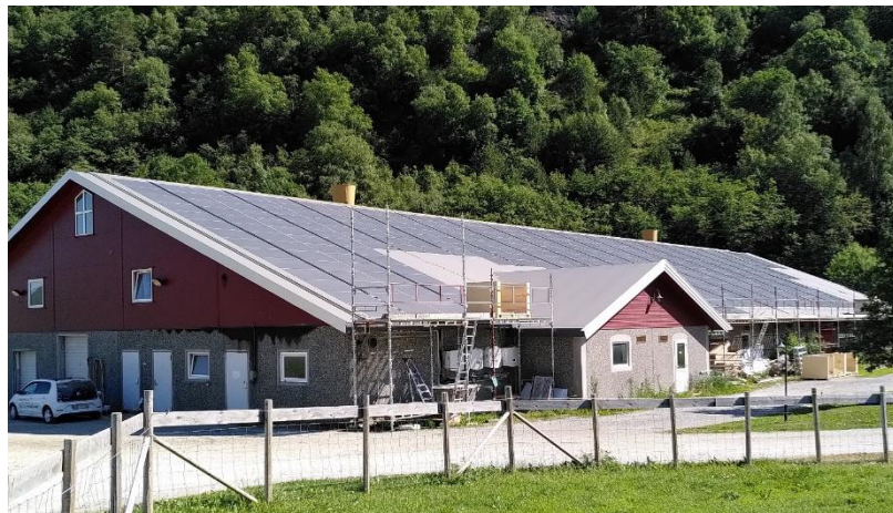
装机容量：137 KW，项目地点：挪威
